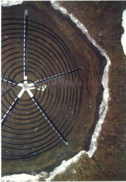
ERDSPEICHER UNTER DEM HAUS
