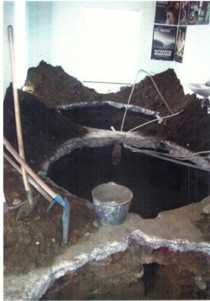
ERDSPEICHER UNTER DEM HAUS
